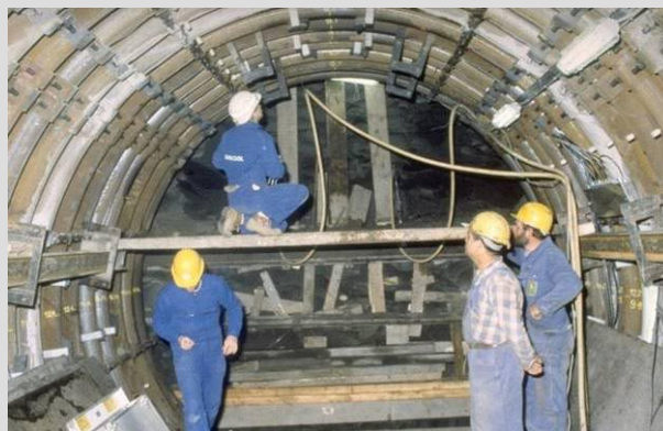
Figure 3.27 Les trois types de revêtement utilisés jusqu'à présent dans l'installation souterraine : en haut, voussoirs en fonte nodulaire (galerie expérimentale HADES) ; au milieu, claveaux en béton (petite galerie et Test Drift) ; en bas, cintres métalliques coulissants (Test Drift, partie ANDRA).
