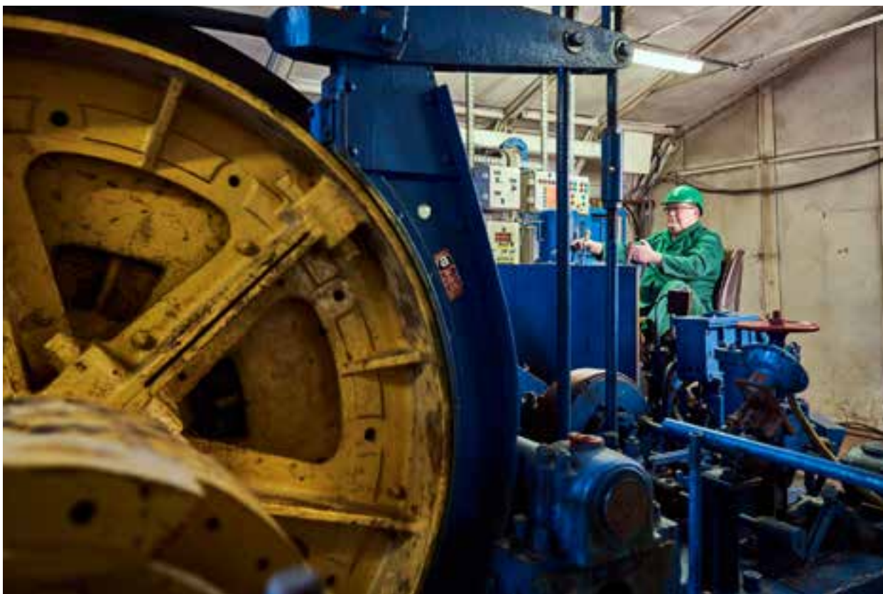
De renovatie is onder meer nodig omdat het steeds moeilijker wordt om vervangstukken te vinden voor de ophaalinstallatie.
